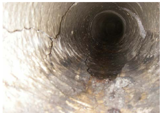
Abbildung 14: Dokumentieren eines Rohrschadens (Quelle: VDRK)
